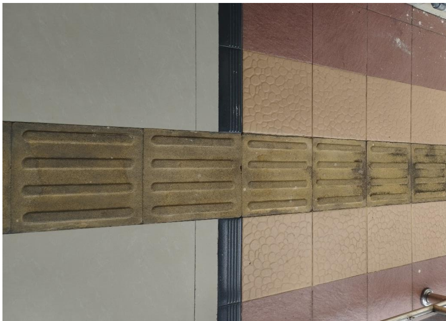
GUIDING BLOCK UNTUK DIFABE KANTOR UPTPK SRAGEN
